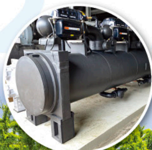
高効率冷凍機による熱供給
